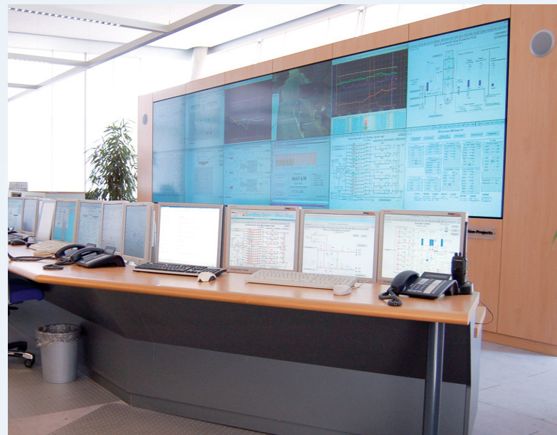
Zentralwarte Klärwerk Hamburg mit Großbildprojektionswand. Quelle: Fa. KH-Automation Projects GmbH, Fuldaabrück.
